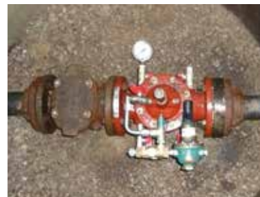
Vanne de régulation de pression (source : OIEau)
